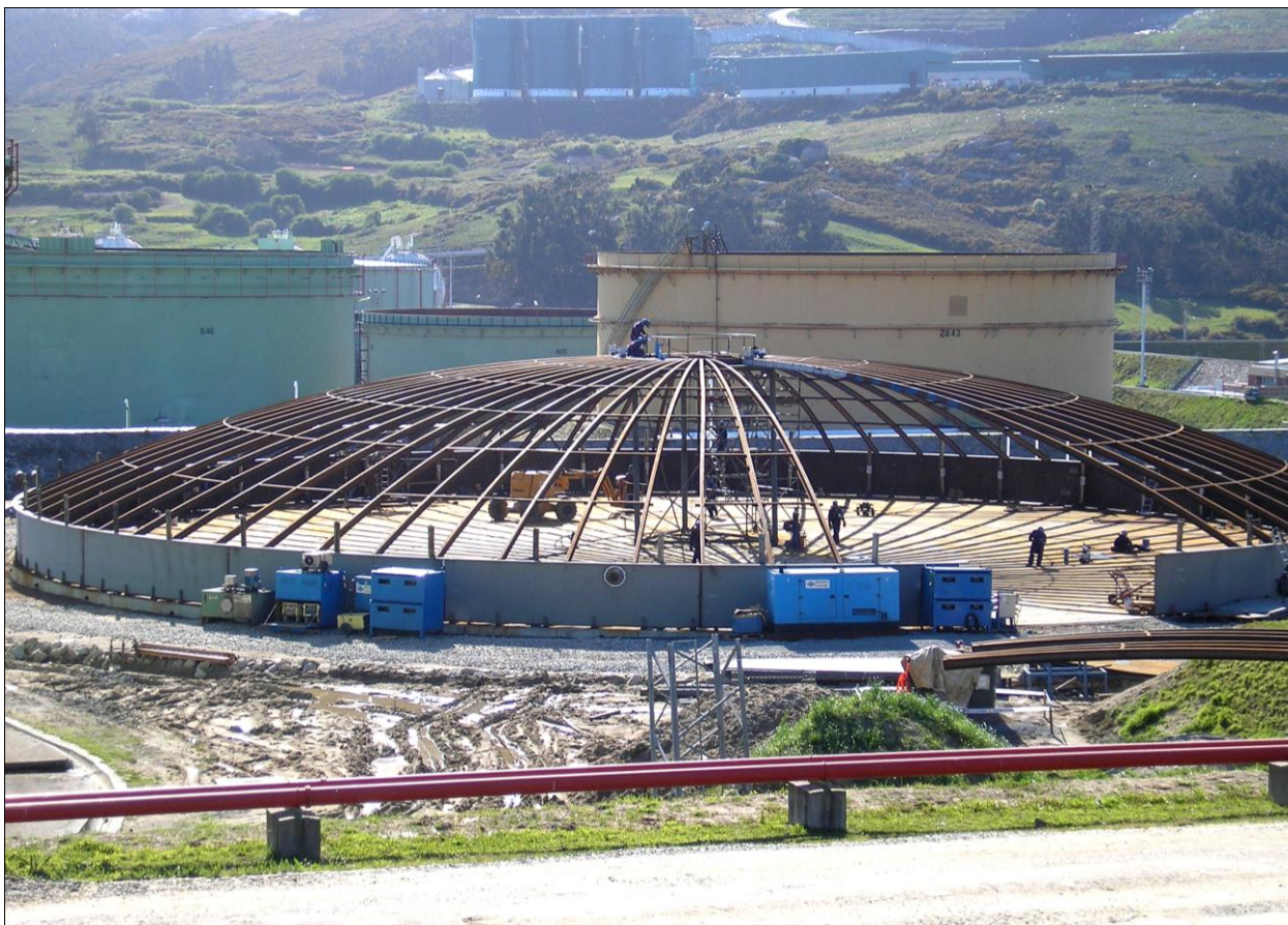
Tanques (2) de almacenamiento de Gas oil ( \varnothing 50 \times 22 mtrs – 43.196 m3) para Repsol (Refinería A Coruña)
