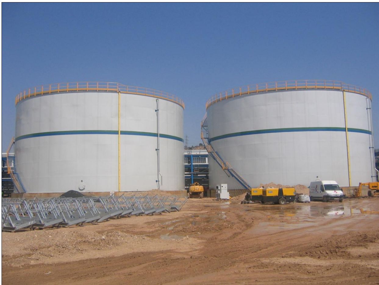
Tanques (5) almacenamiento Gas Oil (52.300 m3) para Enel Power (C.C. Escatrón)
