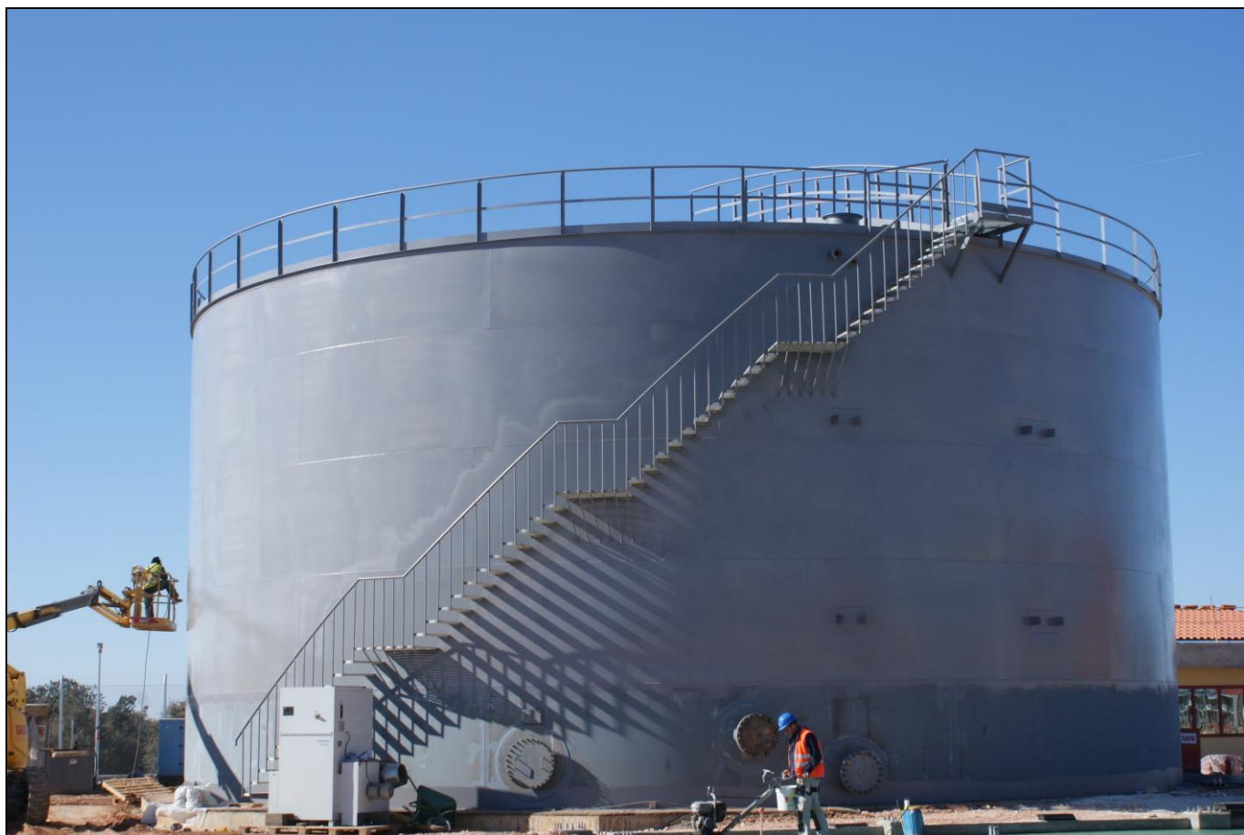
Tanques (5) almacenamiento para Enagas (I.A. Gas Yela-Guadalajara)
